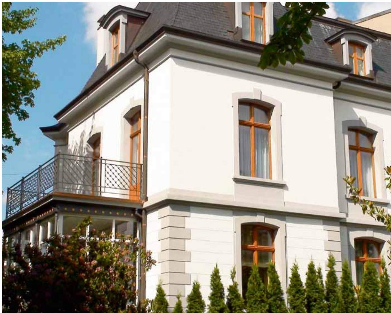
Das stattliche Haus erstrahlt nach der erfolgreichen Sanierung der Fenster im alten, neuen Glanz.
