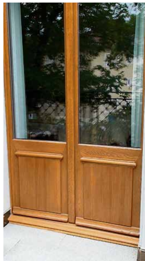
Kassettenfüllung in der Balkontüre.
